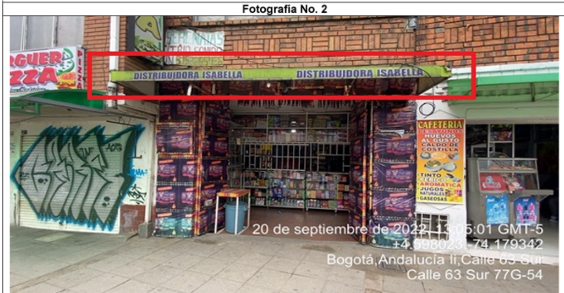
En la cual se evidencia un (1) elemento PEV, perteneciente al establecimiento comercial denominado DISTRIBUIDORA ISABELLA , el cual se encuentra volado de la fachada y es adicional al único elemento permitido por fachada de establecimiento.
